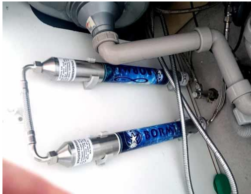
Untertischmontage für Trinkwasser
